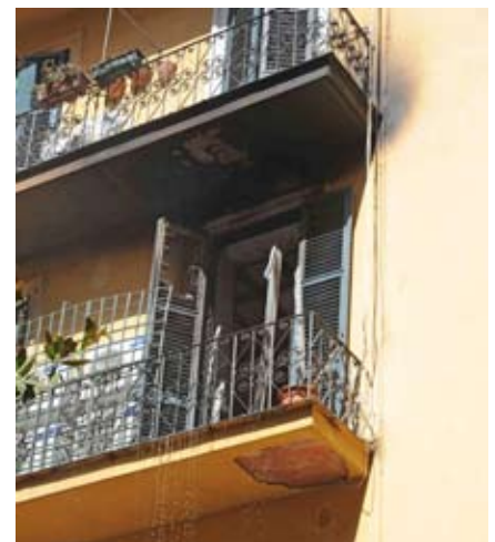
Il gas può causare esplosioni.
