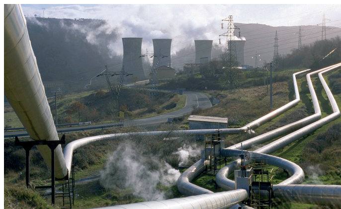
figura 2 Centrale geotermica di Larderello.
