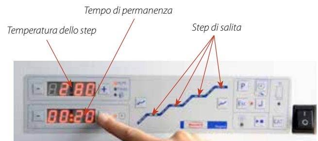
➤ Centralina di comando
