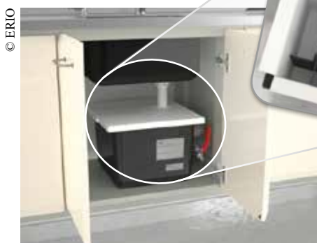
Vasca di decantazione: la presenza degli scomparti e la diversa altezza degli scarichi in ingresso e uscita permettono di separare i fanghi dalle acque reflue.
