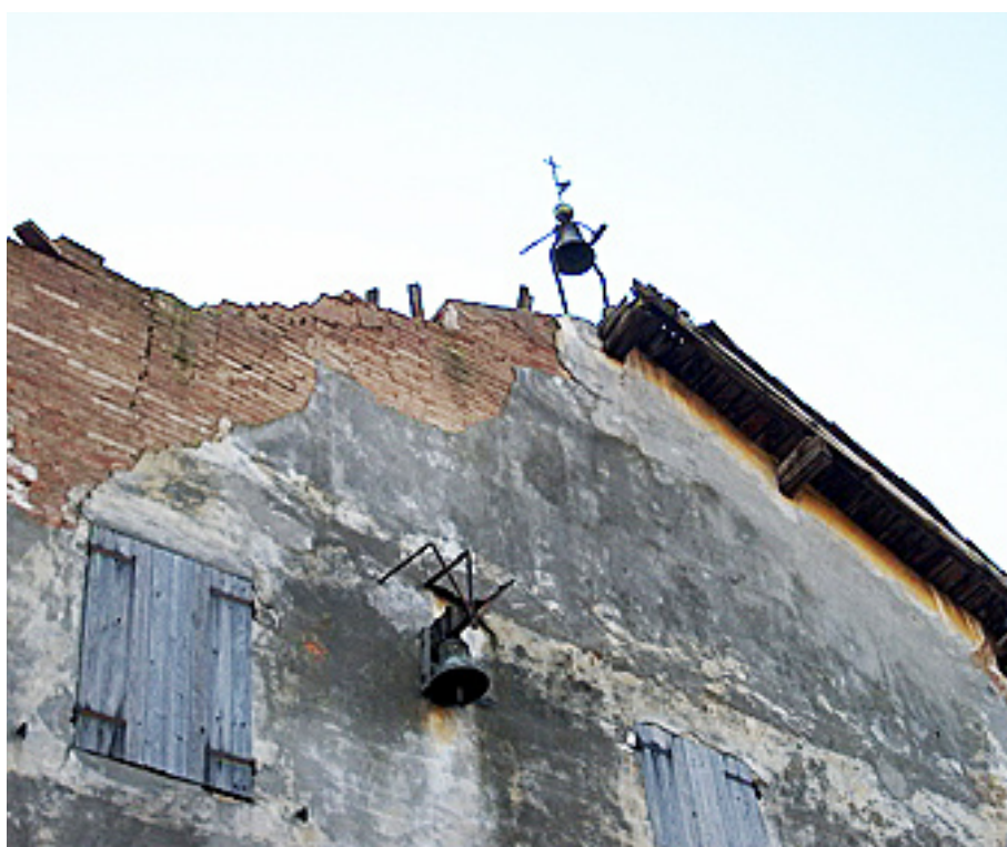
FIGURA 2 Sulla sommità della facciata della Villa rimangono le tracce dell'antico campanile a vela .
