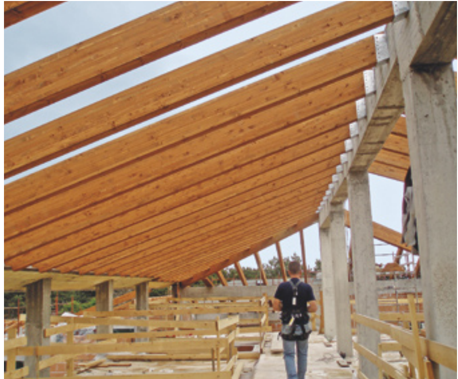
FIGURA 73 Le travi inclinate in legno appoggiano sulle travi orizzontali di cemento armato.
