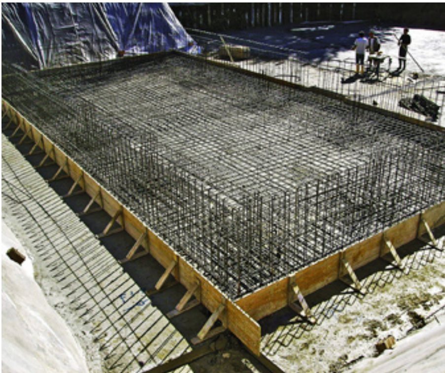
FIGURA 56 Armature della platea dell'edificio C; sono predisposte le casseforme di sponda che conterranno il getto del calcestruzzo.
