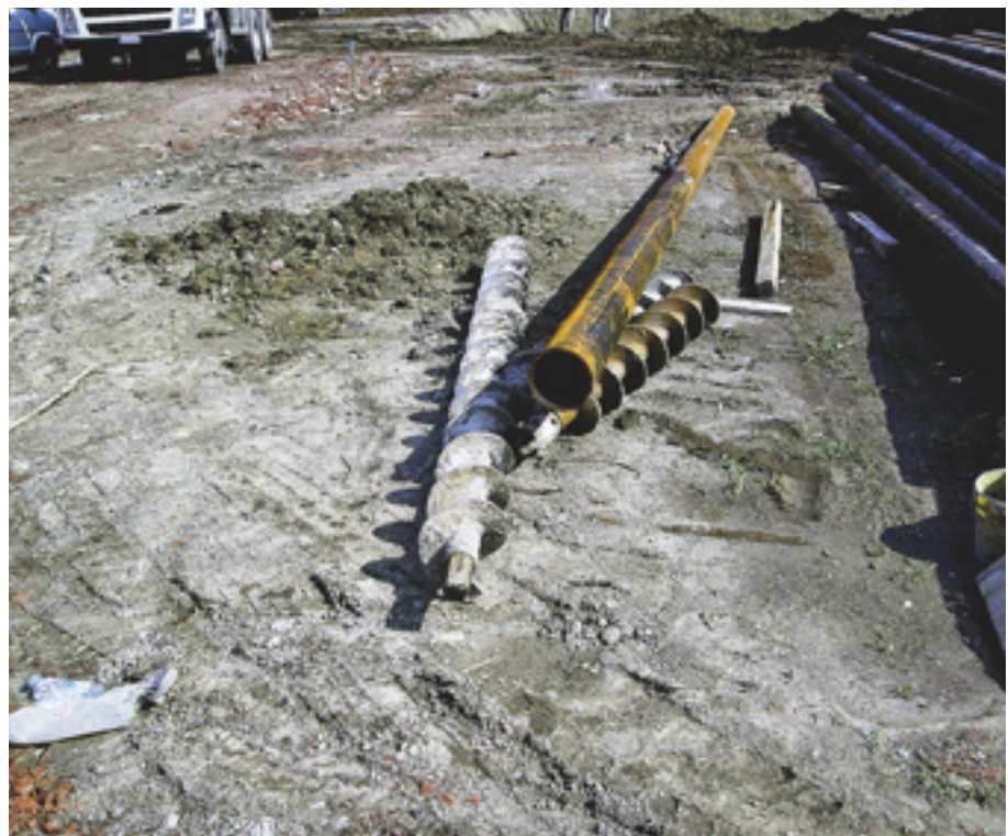
FIGURA 42 Punte elicoidali per la trivellazione del terreno e pali metallici per la realizzazione della paratia.
